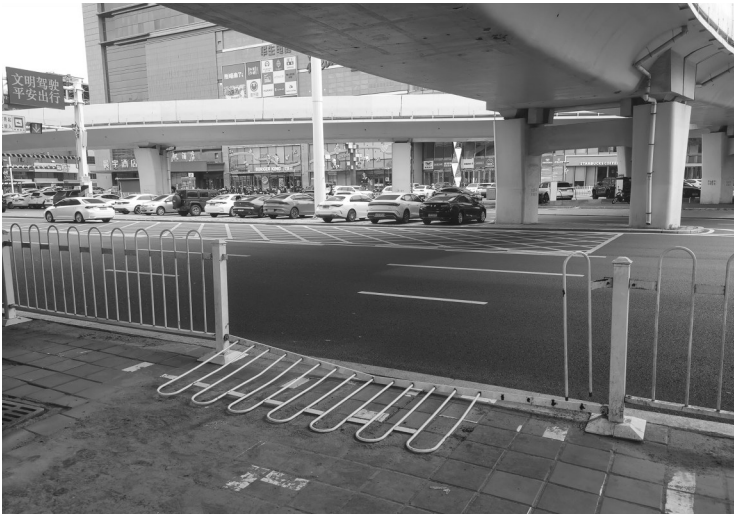
一段长约2米的护栏损坏倒地
