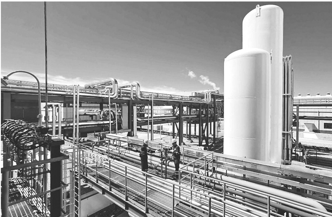
日前,国家电投大安风光制绿氨合成氨一体化示范项目建成投产,该项目是全球最大绿色合成氨单体项目,创下“绿氨规模、混合制氨规模、直流微网和固态储氨”四项全球之最。图为工人正在进行仪表空气外送操作。 石雷 王凝钰 摄
