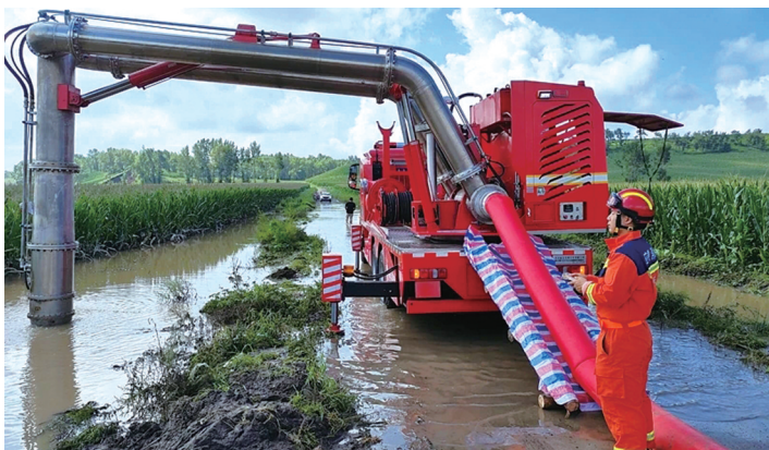
之前在榆树抗洪排涝中发挥重要作用 消防供图
