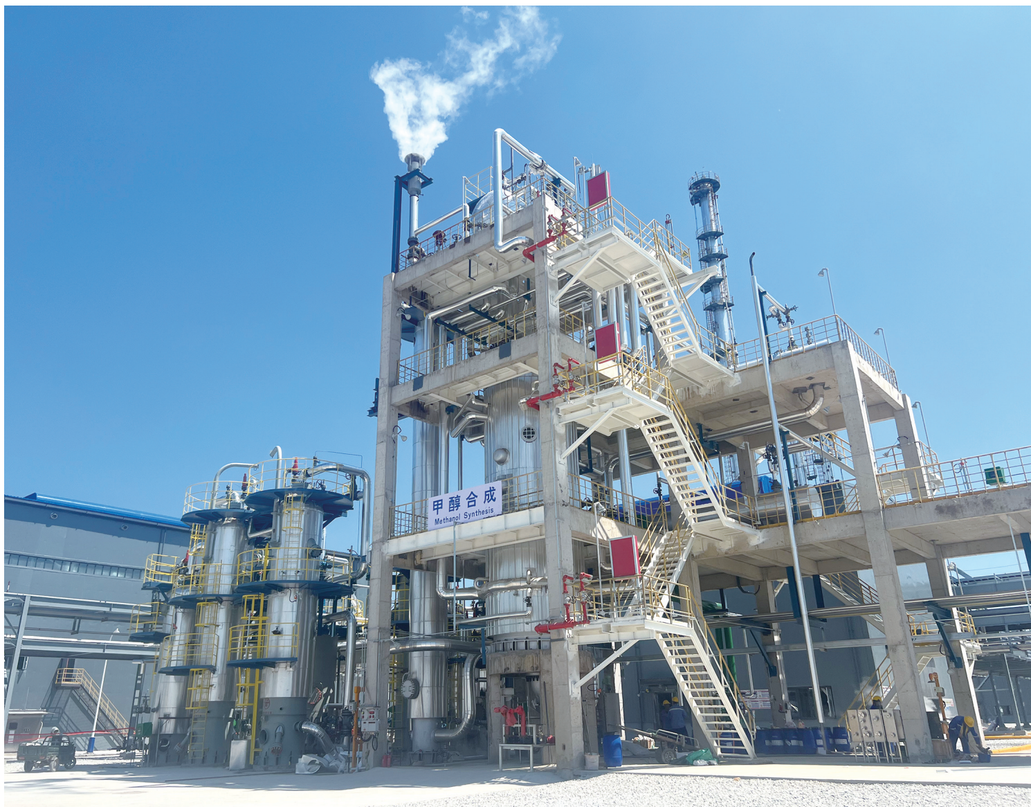
上海电气洮南市风电耦合生物质绿色甲醇一体化示范项目厂区一角。记者 段卫军 摄
