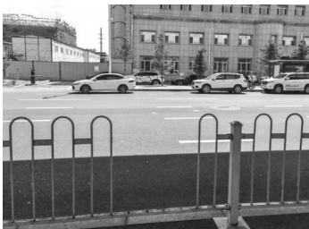
之前出现约半米宽的豁口
