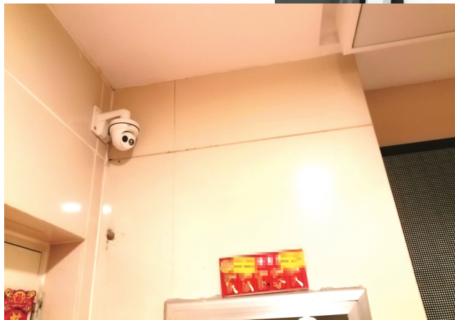
楼道内的摄像头
