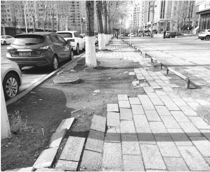
方砖缺失,沙土裸露在外 城市晚报全媒体记者 陆续 摄
