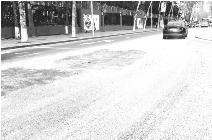
路面出现塌陷坑洼 城市晚报全媒体记者 刘佳雪 摄
