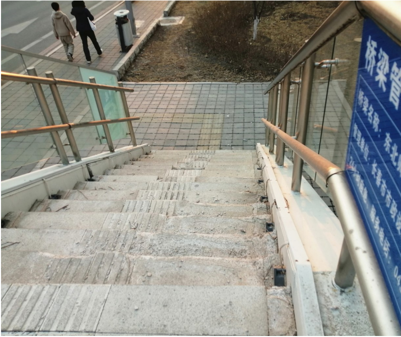
破损的台阶亟待修复
