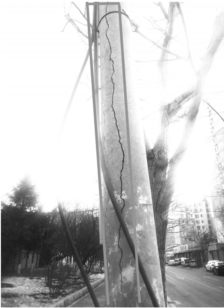
发现裂缝的水泥路灯杆 城市晚报全媒体记者 刘佳雪 摄
