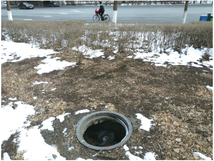
井盖丢失 本组图片 城市晚报全媒体记者 刘佳雪 摄
