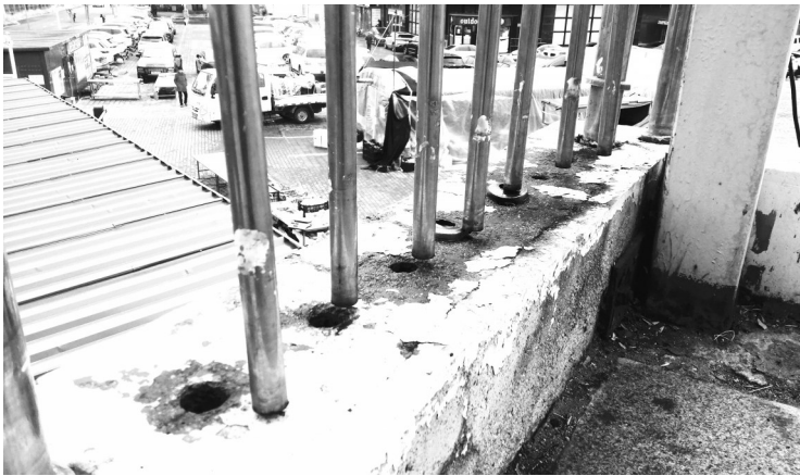
栏杆破损存在安全隐患 城市晚报全媒体记者 刘佳雪 摄
