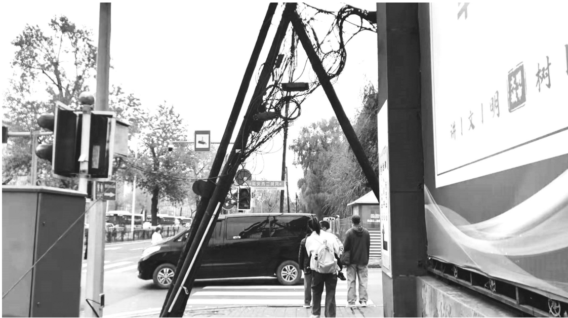
线缆横跨人行道上方,存在安全隐患 城市晚报全媒体记者 刘佳雪 摄
