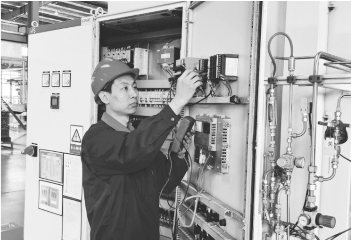
张虎在检查设备运行情况。
