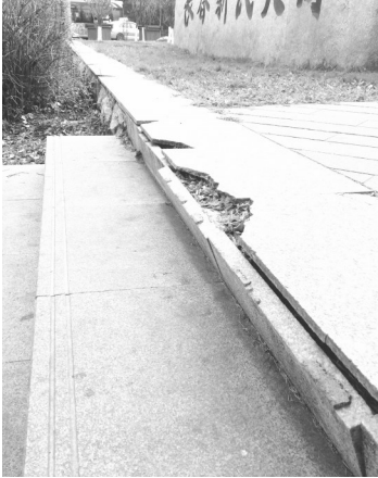
台阶多处出现破损 城市晚报全媒体记者 刘佳雪 摄
