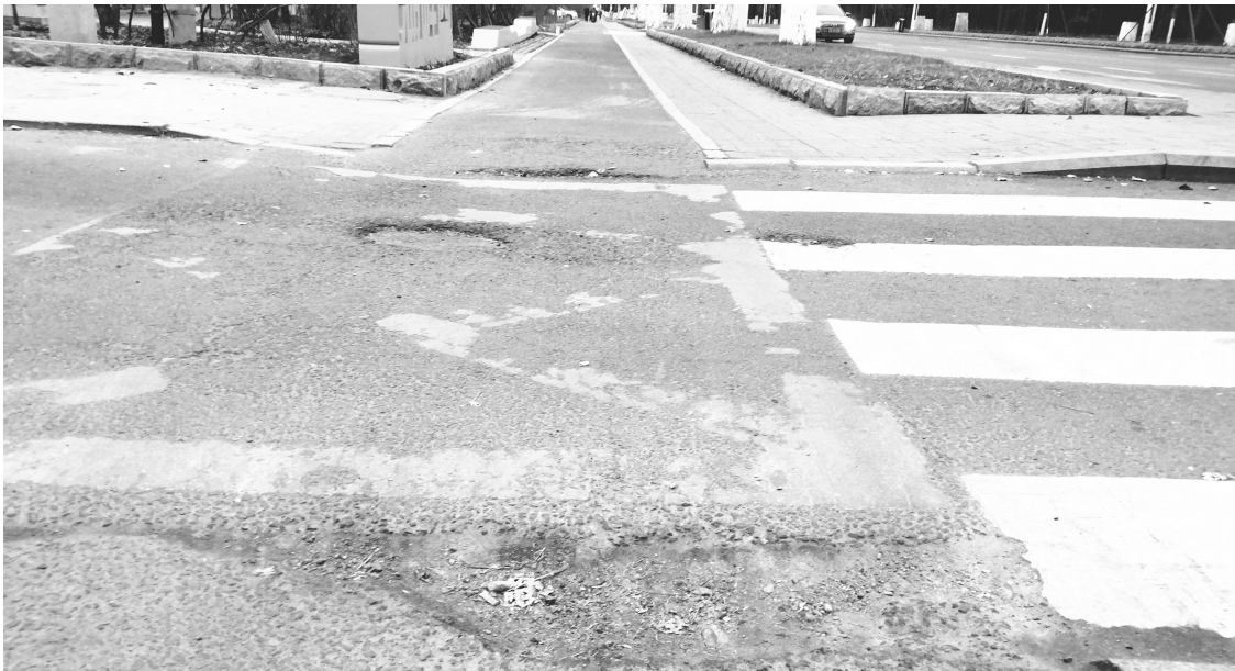
破损路面亟待修复 城市晚报全媒体记者 刘佳雪 摄
