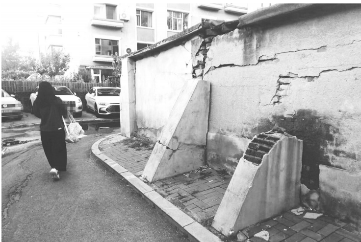
院墙倾斜开裂 城市晚报全媒体记者 刘佳雪 摄
