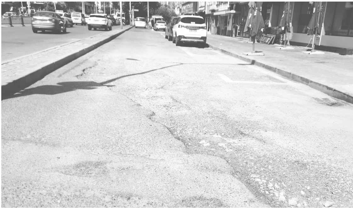
路面有大面积的砂石裸露 城市晚报全媒体记者 刘佳雪 摄
