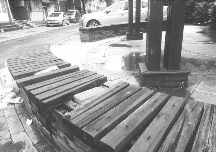
座椅破损亟待修缮 城市晚报全媒体记者 刘佳雪 摄
