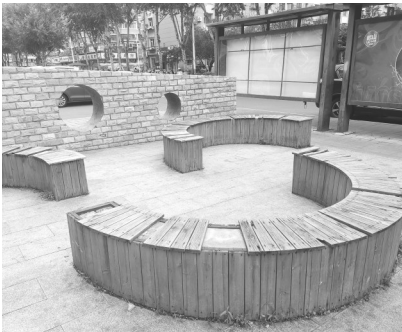
休闲座椅之前存在多处损坏情况
