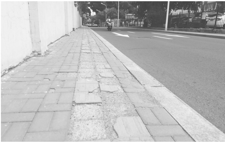
此处的人行道方砖破损 城市晚报全媒体记者 刘佳雪 摄
