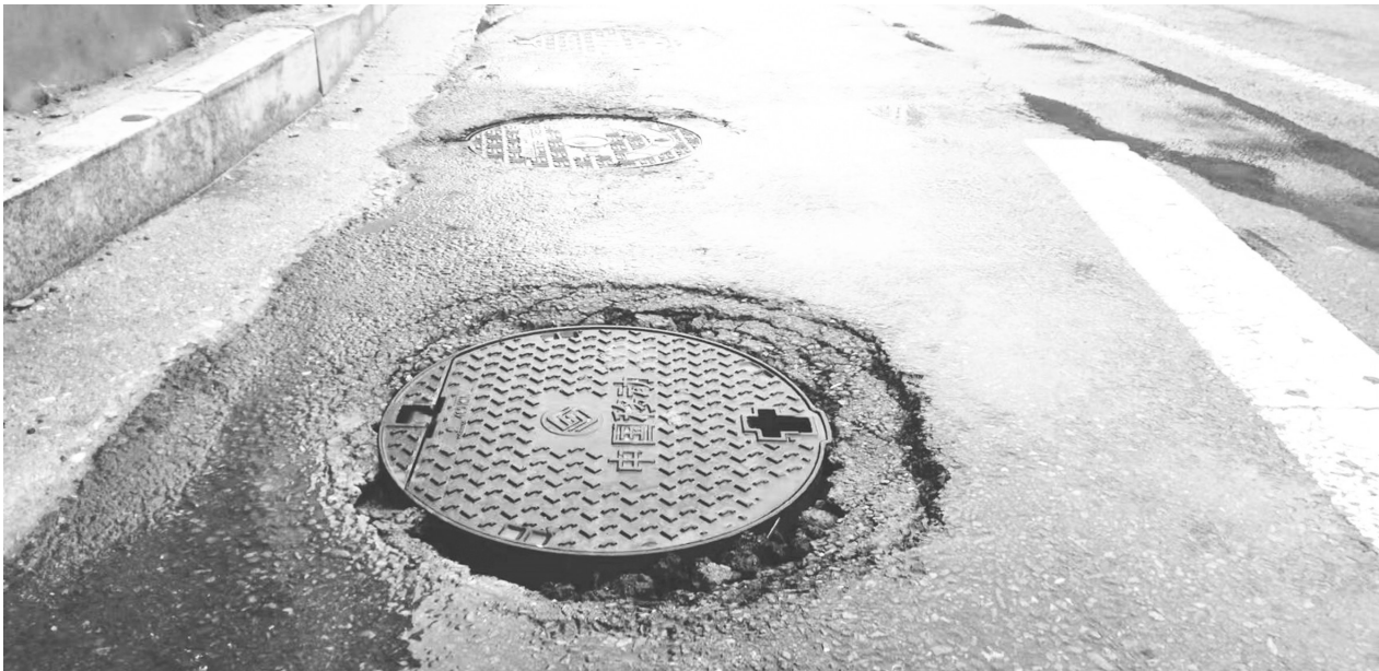
井盖已经塌陷 城市晚报全媒体记者 刘佳雪 摄
