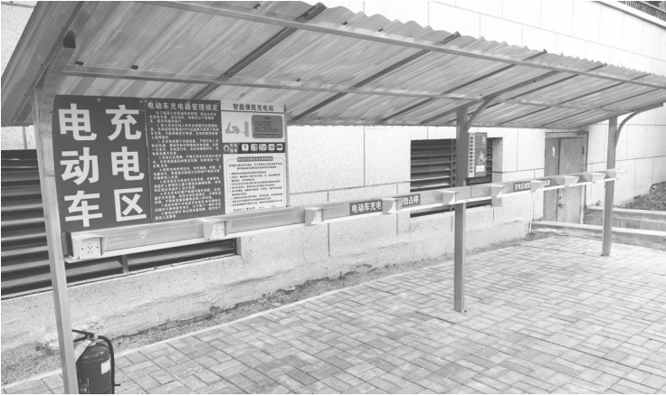
小区内新近建设的电动自行车充电站 城市晚报全媒体记者 陆续 摄
