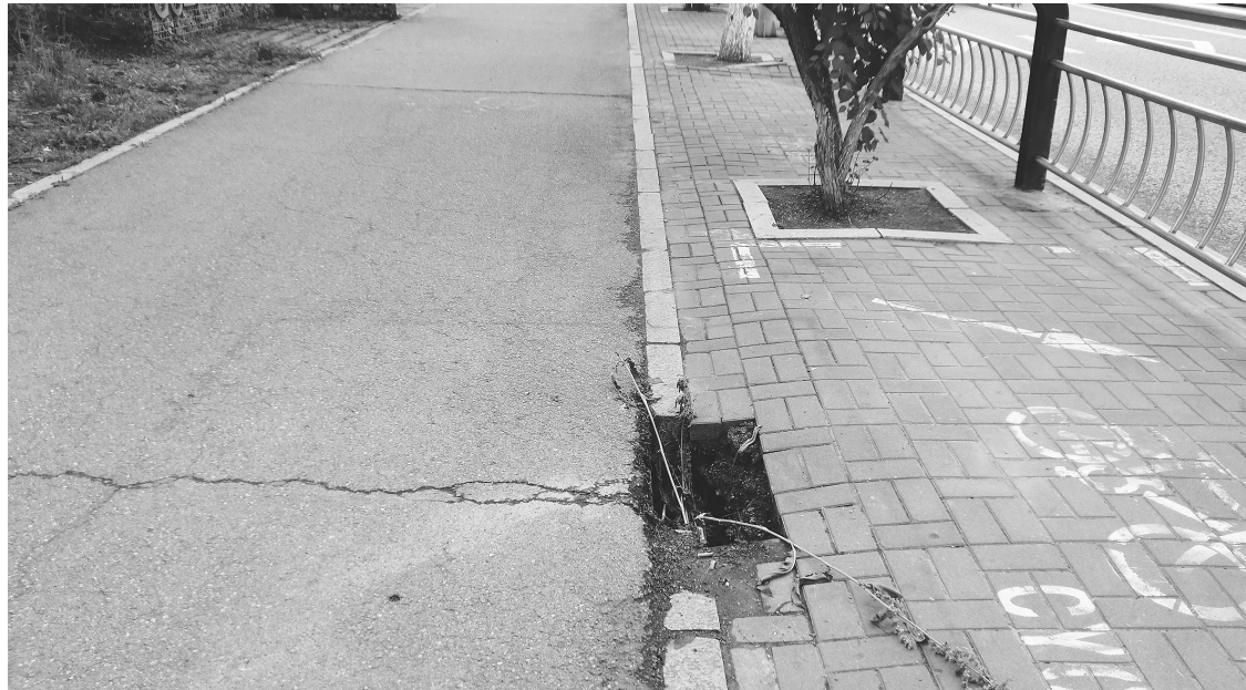
人行步道塌了个坑,存在安全隐患 城市晚报全媒体记者 刘佳雪 摄
