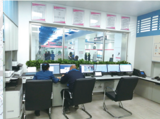
站内安全监控室
