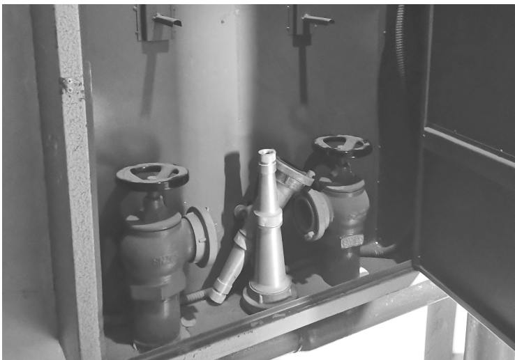
这里的消火栓没水没消防水带 城市晚报全媒体记者 刘佳雪 摄
