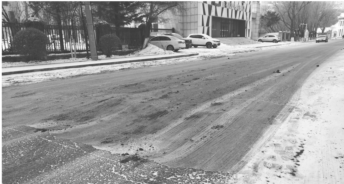
路面出现坑洼塌陷 城市晚报全媒体记者 刘佳雪 摄
