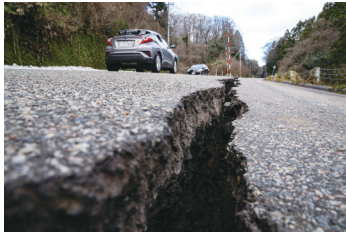
1月2日,在日本石川县羽咋郡,道路被地震损坏。新华社记者 张笑宇 摄
