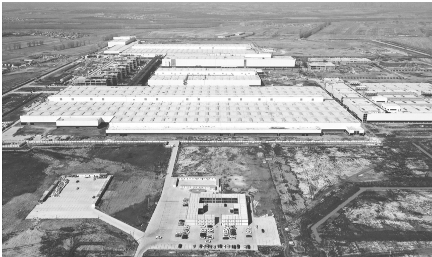
长春的奥迪一汽新能源项目施工现场(2023年3月9日摄,无人机照片)。新华社发 王勐 摄
