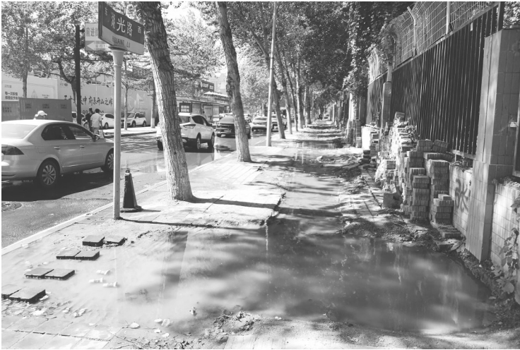
数十米的路面被挖开后未恢复原貌 城市晚报全媒体记者 刘佳雪 摄
