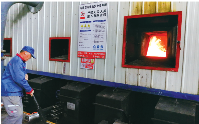
技术人员在监控锅炉燃烧情况 城市晚报全媒体记者 刘佳雪 摄
