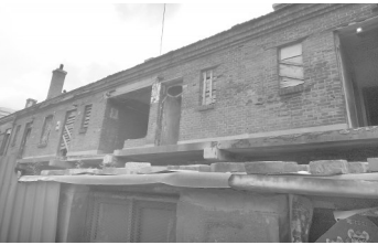
破败的新民胡同房屋
