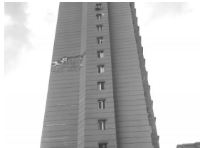
居民楼外墙大块墙皮脱落
