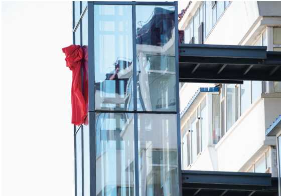
邮电小区安装的电梯即将投入使用
