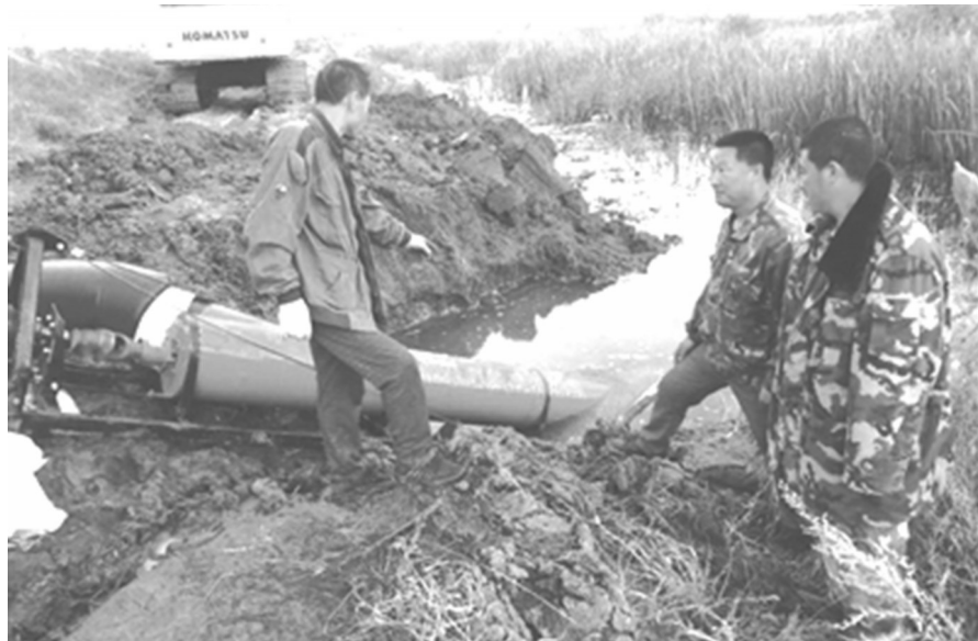
图为中华保险镇赉支公司捐赠的大功率排水泵助力稻田排水
